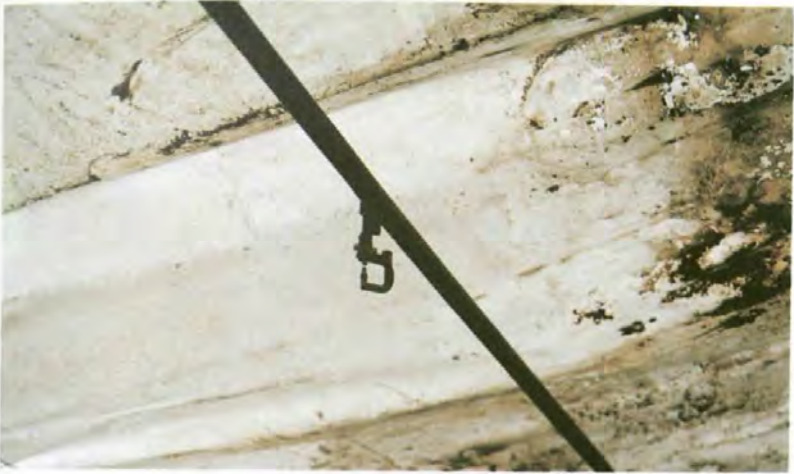
Resim 22: Kurulu Serada Isıtma Boruları ve Sisleme (Ş.Bekişoğlu, Ocak, 2001)
