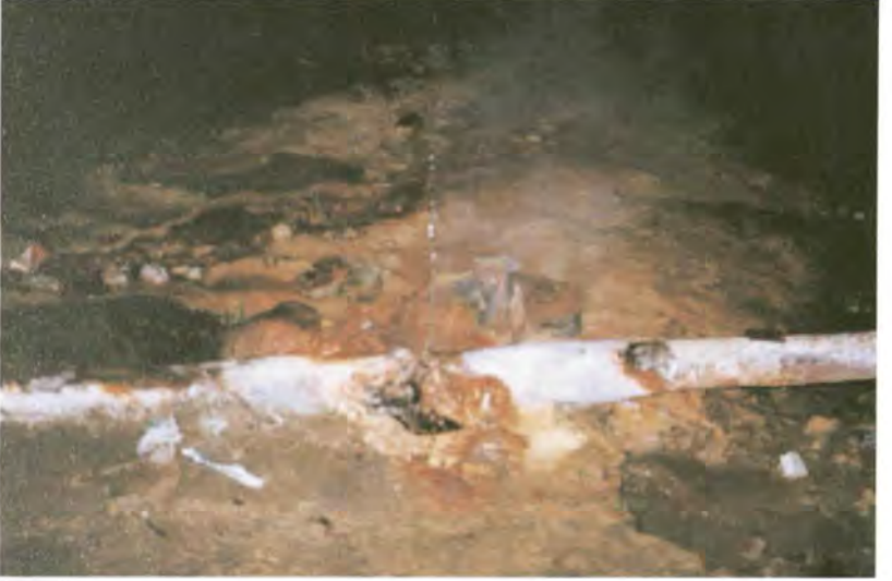
Resim 4: Demir Boruda Korozyon Nedeniyle Meydana Gelen Çürümeye ve Delinme (Ş. Bekişoğlu, Ocak, 2001)
