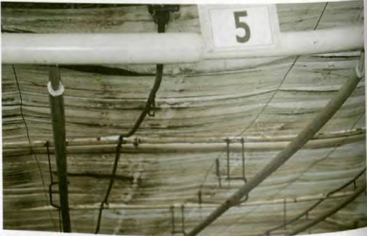
Resim 21: Kurulu Serada Isıtma Boruları ve Sisleme (Ş.Bekişoğlu, Ocak, 2001)
