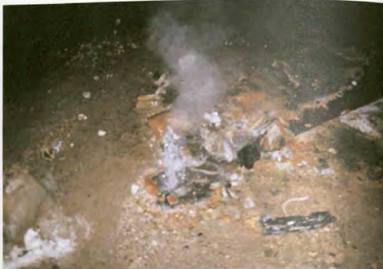
Resim 5: Demir Boruda Korozyon Nedeniyle Meydana Gelen Çürüme ve Delinmenin Zemindeki Görüntüsü (N. Özel, Ocak, 2001)
