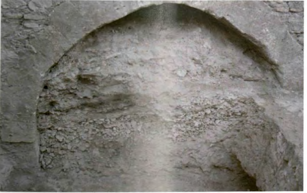
Resim 165: Yapıda görülen yoğun toprak ve moloz (atık malzeme) dolgusu.
