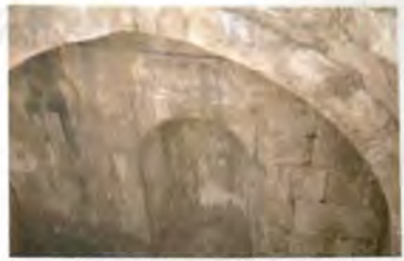
Resim 295 Birecik Merkez Bucağı, Doruçak Köyü, Şeyh Bekir Türbesi, İç Mekân, Güneye Bakış
