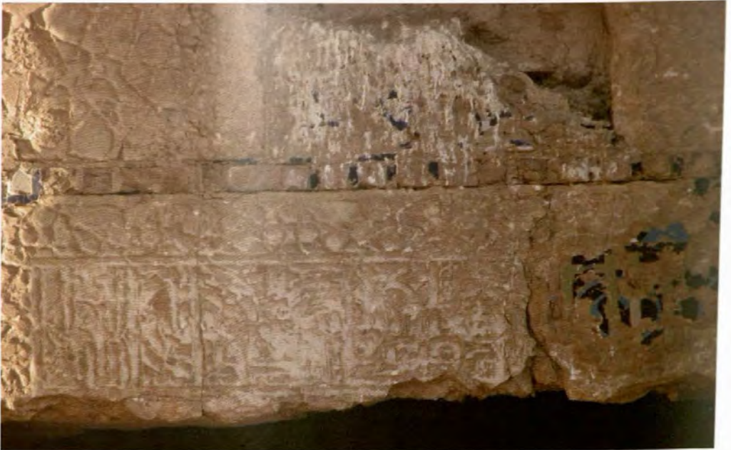
Resim 368: Dış yüzeyde oluşan kirlenmeler
