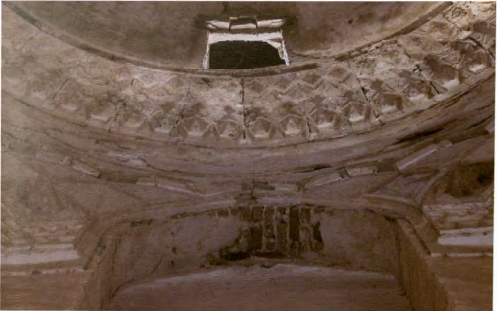
Resim 364: Beden duvarlarında oluşan tahribat
