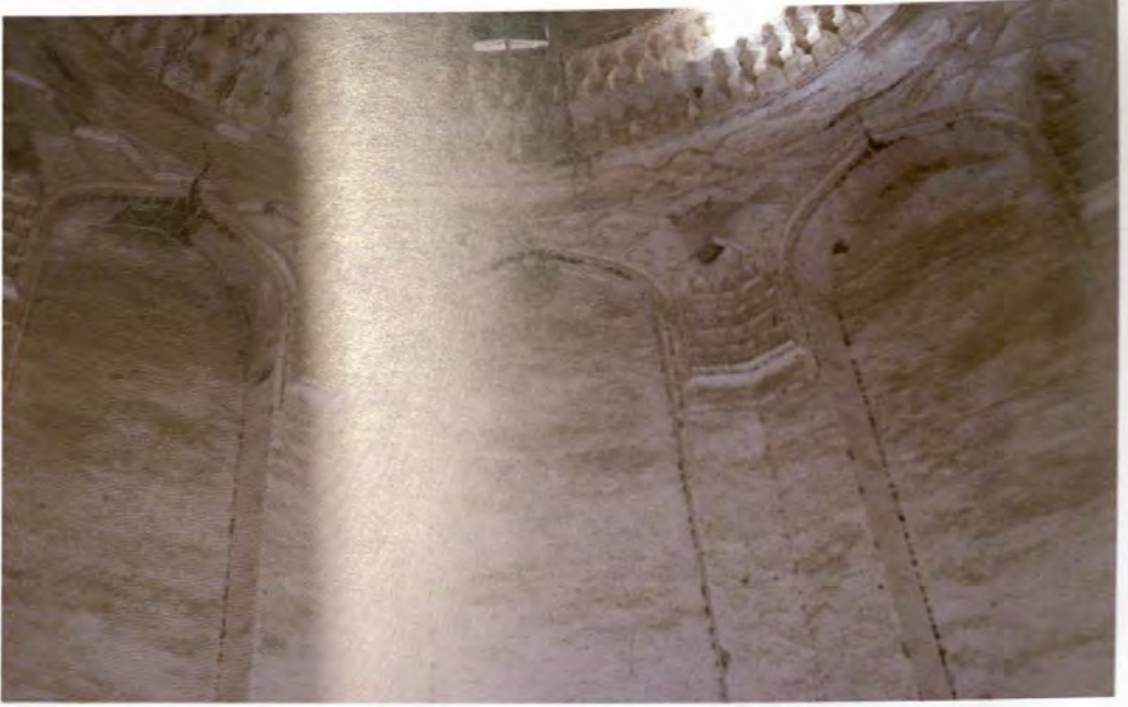
Resim 367: İç yüzeyde oluşan kirlenmeler
