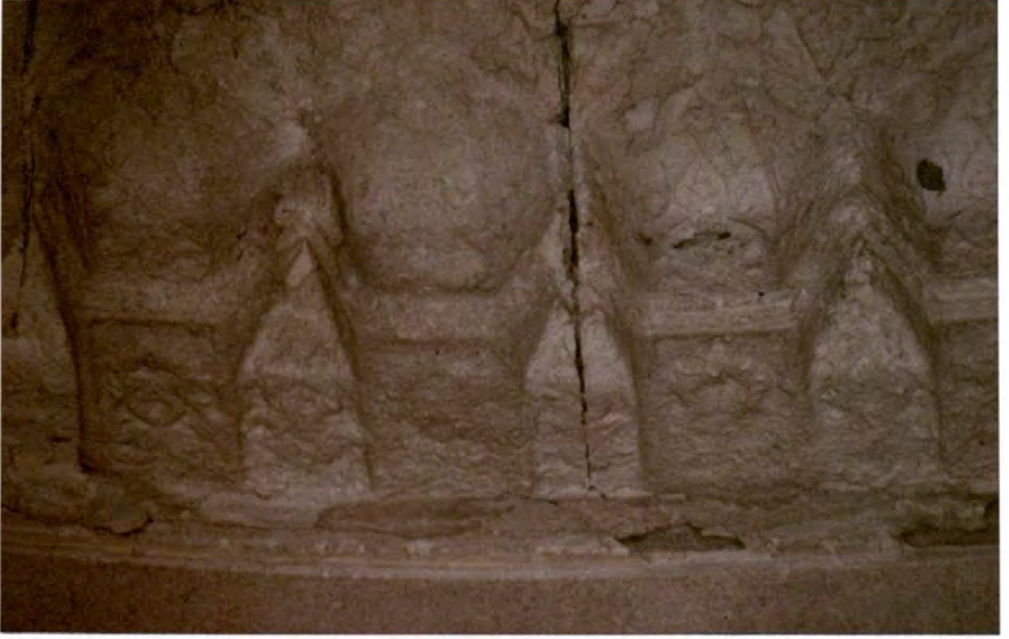
Resim 365: Beden duvarlarında oluşan tahribat
