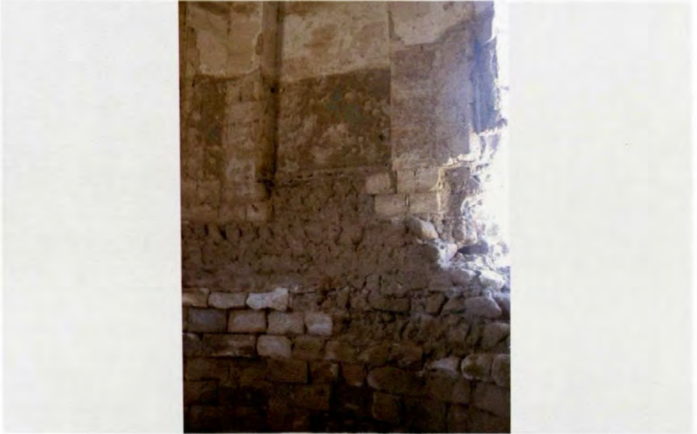
Resim 366: Beden duvarlarında oluşan tahribat
