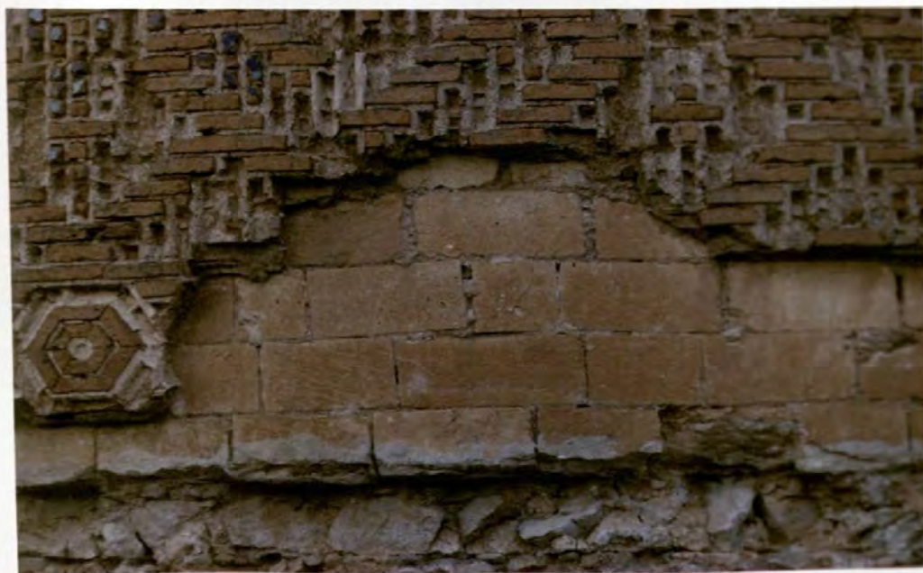
Resim 378: Taş bloklar ve tuğla örgü arasındaki derz harçlarının dökülmesi
