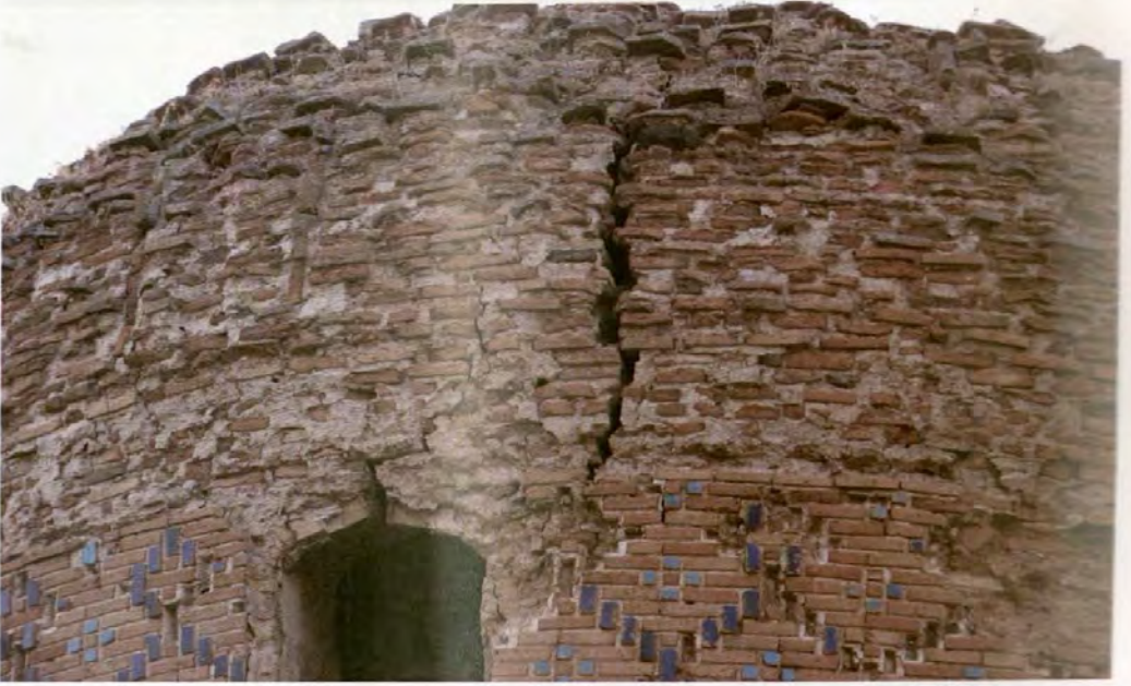
Resim 359: Üst örtüde oluşan açılmalar
