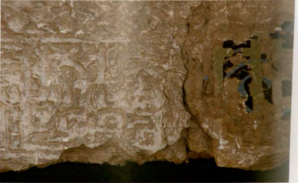
Resim 360: Beden duvarında oluşan açılma ve kırılmalar
