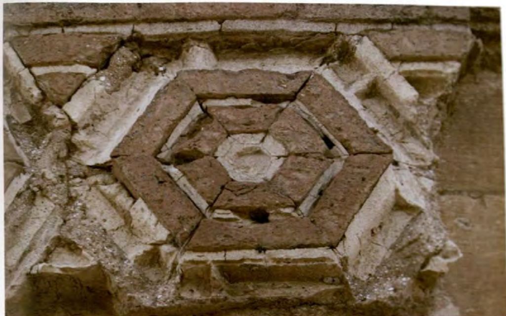
Resim 377: Taş bloklar ve tuğla örgü arasındaki derz harçlarının dökülmesi
