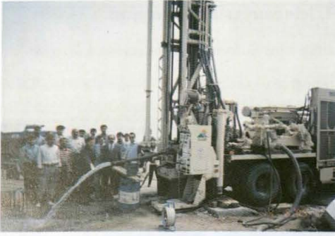
Sırnak-Merkez Pompa Tecrübesi
