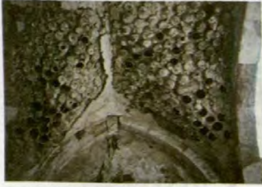
Tonozlu Çatıda Isı Yalıtım Tesisleri
