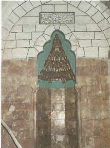
Resim 10 : Hasaniye Camii'nin boyanmış ve bozulmuş mihrabı restorasyon öncesi
