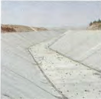
Şanlıurfa Harran Sulaması Ana Kanalı
