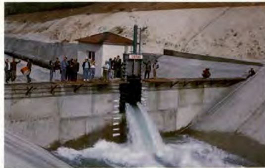
Şanlıurfa Tünelleri By-Pass Boru Hattı Regülasyon Vanası
