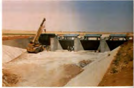
Şanlıurfa Ovası Sulaması, Sulama Kanalları Kanal Kapakları
